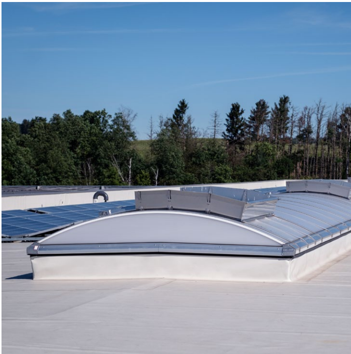
LAMILUX Lichtband B auf der Industriehalle von Bang Kransysteme in Oelsnitz
