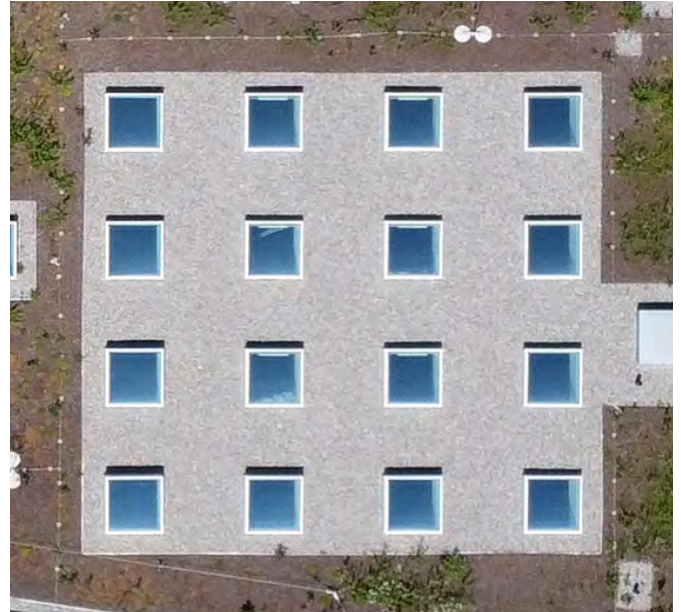
Flachdach Fenster von LAMILUX auf dem Dach des Gebäudes
