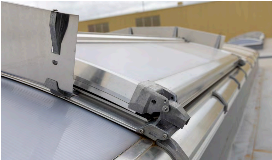
Verbaute Rauch- und Wärmeabzugsklappe
