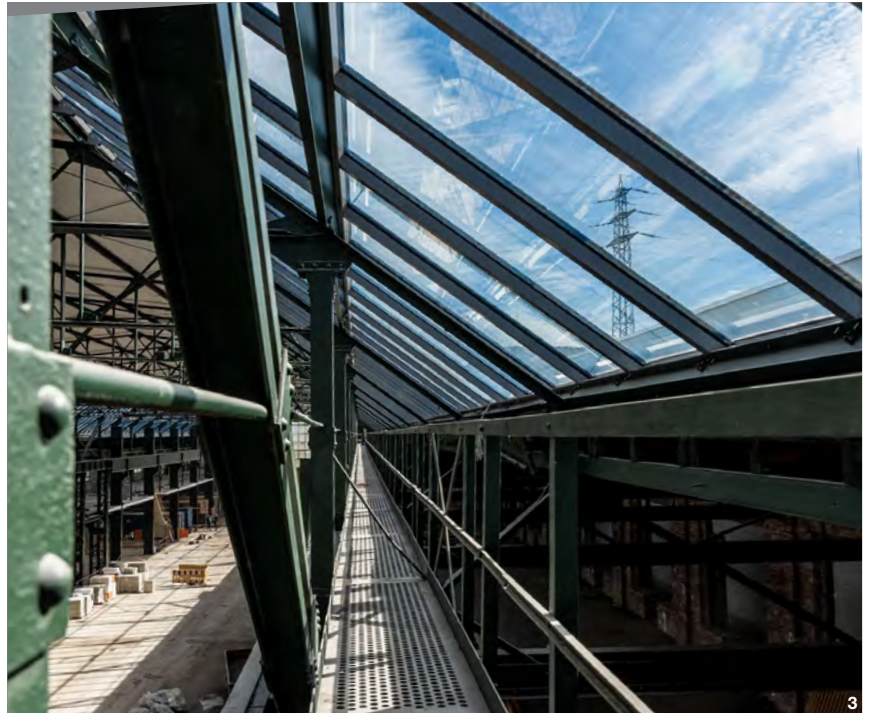
[3] LAMILUX Glasdach PR60 des Boulevardgebäudes des Factory Campus Düsseldorf
